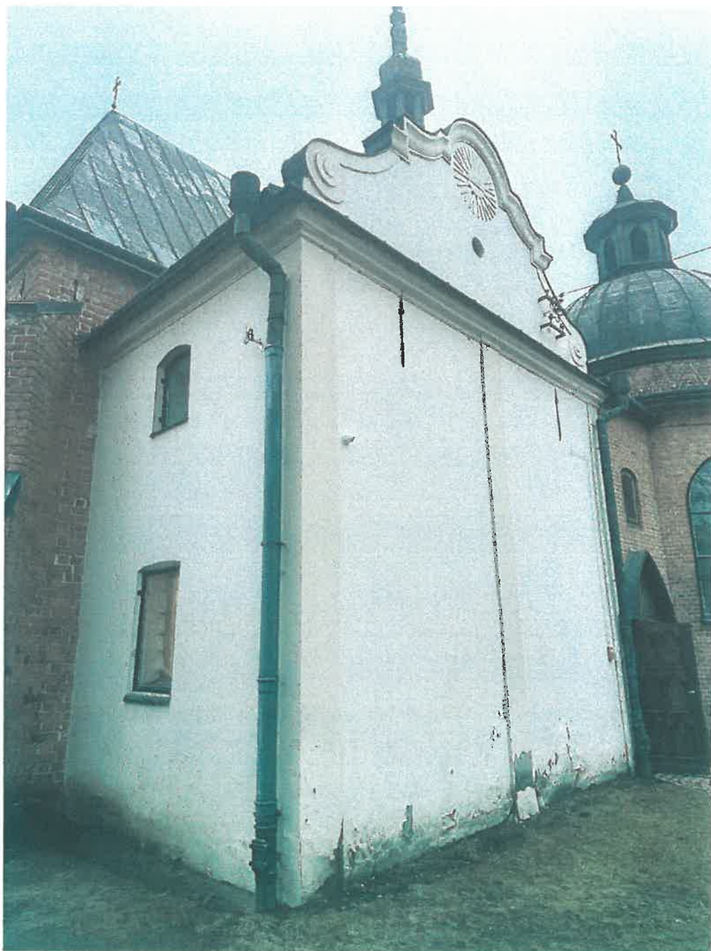
Fot. nr 5 Kościół parafialny p.w. św. Mari Magdaleny w Tarnobrzegu-Miechocinie Widok zniszczeń wypraw tynkarskich w strefie cokołowej zakrystii.
