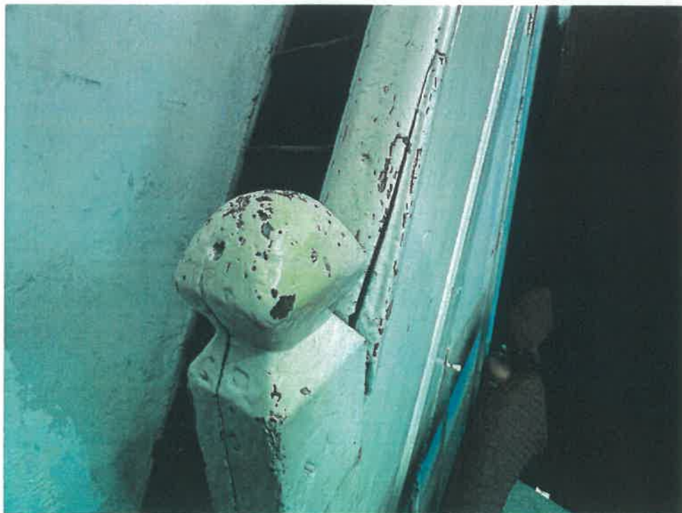
Fot. nr 16 Kościół parafialny p.w. św. Mari Magdaleny w Tarnobrzegu-Miechocinie. Widok uszkodzeń uszkodzeń mechanicznych i biologicznych na pochwyicie schodów zakrystii.
