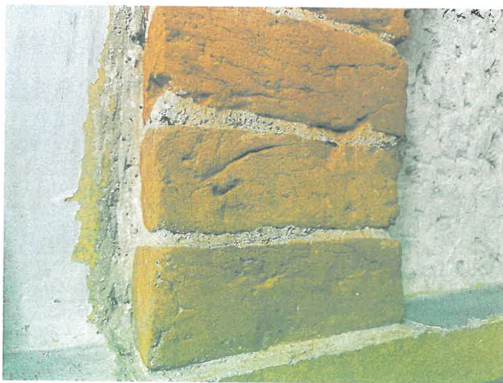
Fot. nr 10 Kościół parafialny p.w. św. Mari Magdaleny w Tarnobrzegu-Miechocinie. Widok wtórnych warstw tynkarskich i odznaczających się miejsc wbudowanej instalacji elektrycznej.
