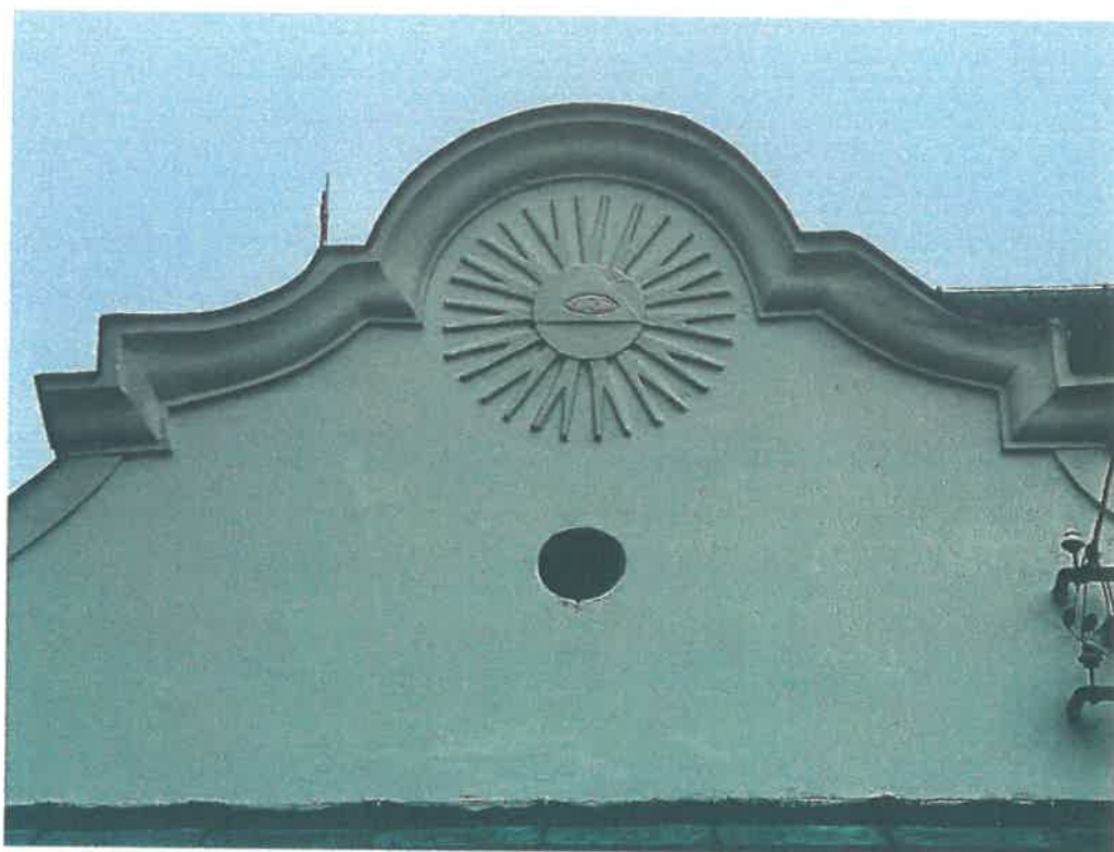
Fot. nr 6 Kościół parafialny p.w. św. Mari Magdaleny w Tarnobrzegu-Miechocinie. Widok miejscowych odspojień współczesnej warstwy malarskiej w zwieńczeniu elewacji.
