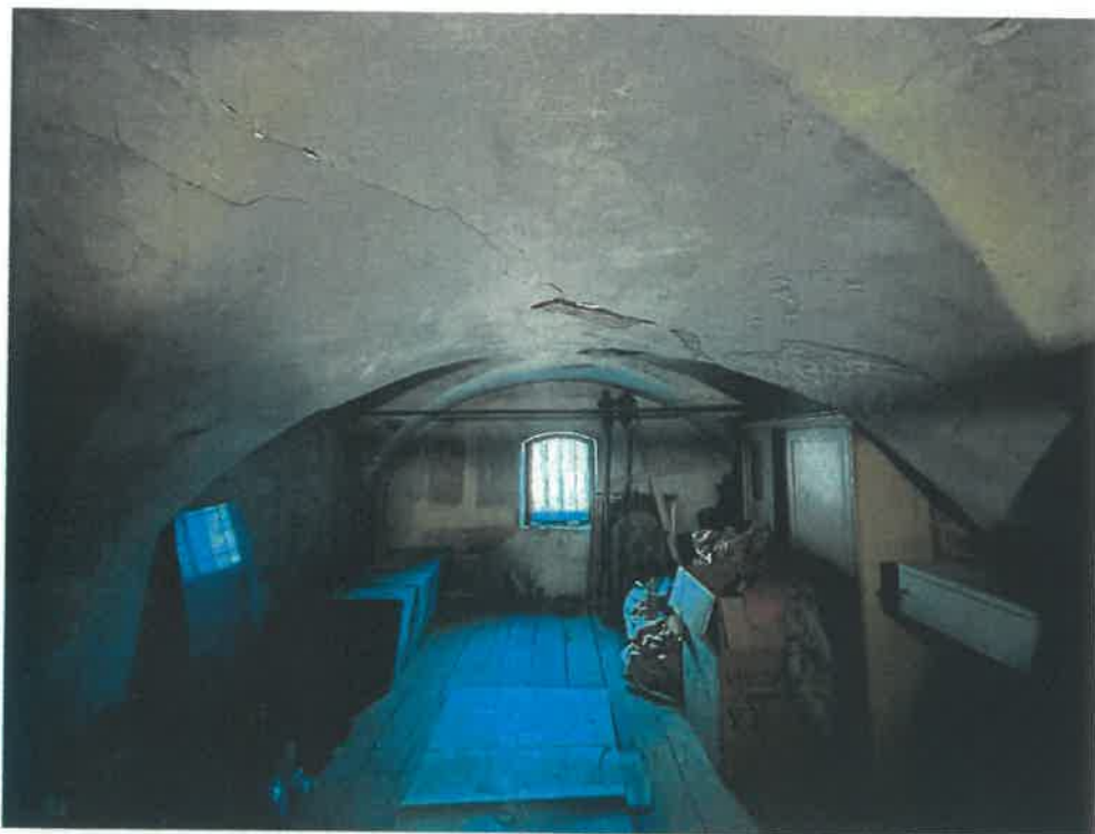
Fot. nr 18 Kościół parafialny p.w. św. Mari Magdaleny w Tarnobrzegu-Miechocinie. Widok stanu istniejącego wypraw tynkarskich we wnętrzu skarbcza nad zakrystią.
