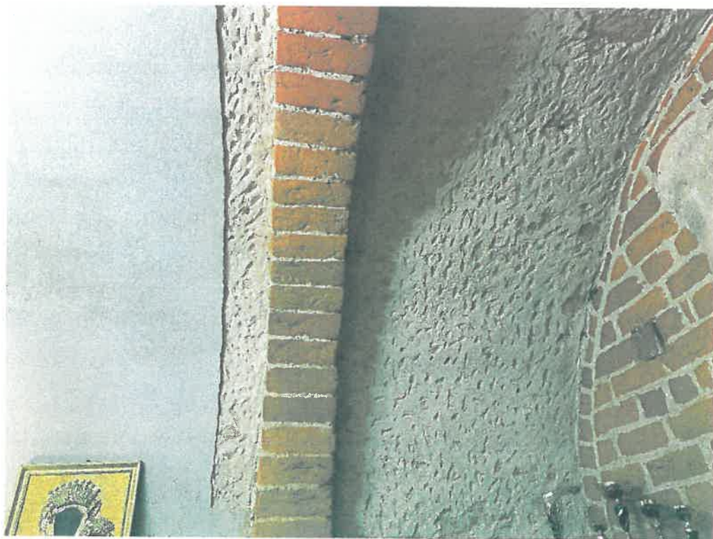
Fot. nr 7 Kościół parafialny p.w. św. Mari Magdaleny w Tarnobrzegu-Miechocinie. Widok stanu istniejącego oryginalnych wypraw tynkarskich we wnętrzu zakrystii.
