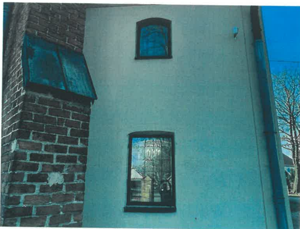
Fot. nr 17 Kościół parafialny p.w. św. Mari Magdaleny w Tarnobrzegu-Miechocinie. Widok stanu istniejącego stolarki okiennej zakrystii i skarbcza nad zakrystią.
