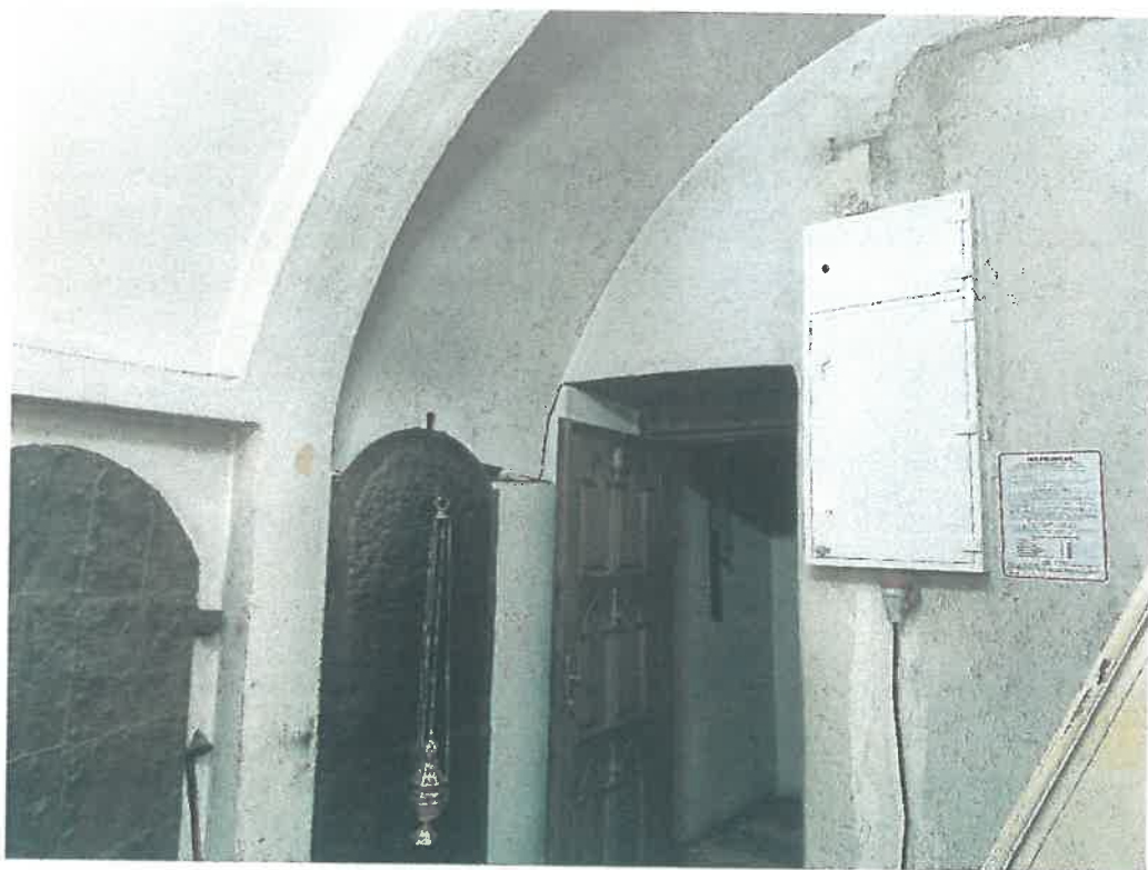
Fot. nr 8 Kościół parafialny p.w. św. Mari Magdaleny w Tarnobrzegu-Miechocinie. Widok wtórnych warstw tynkarskich i odznaczających się miejsc wbudowanej instalacji elektrycznej.
