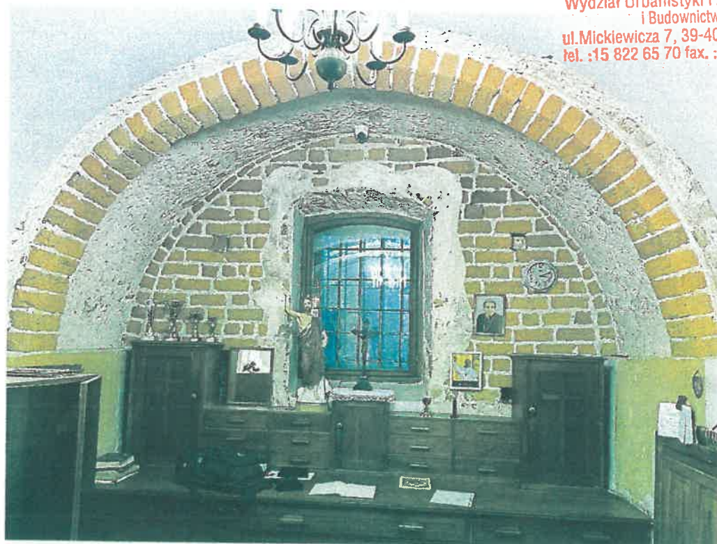
Fot. nr 9 Kościół parafialny p.w. św. Mari Magdaleny w Tarnobrzegu-Miechocinie. Widok wtórnych warstw tynkarskich i odznaczających się miejsc wbudowanej instalacji elektrycznej.
